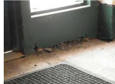
Rusting door frame
